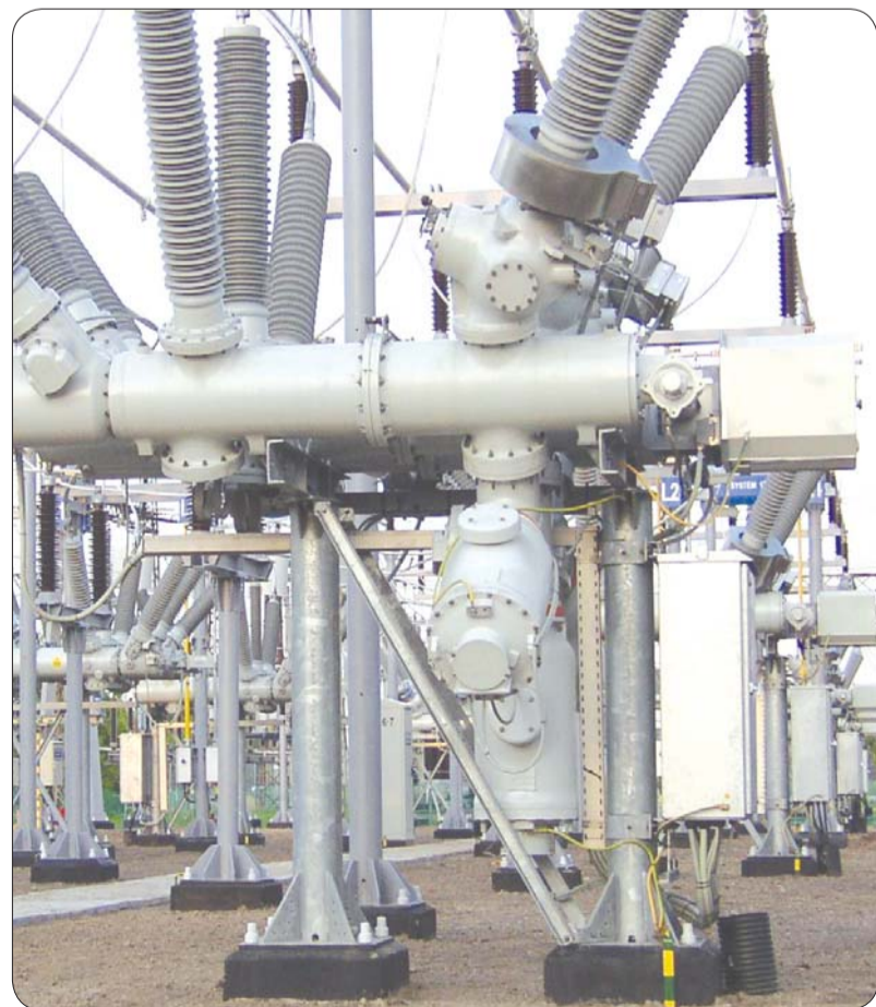
Современное оборудование на энергообъекте ОАО «МРСК Юга»
