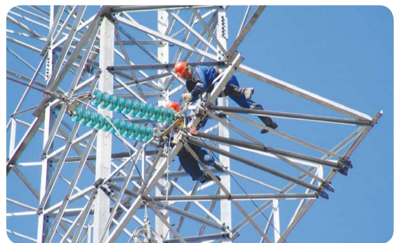
Сотрудники ОАО «Кубаньэнерго» проводят установку провода нового поколения «Aero-Z» на ВЛ Шепси-Тяговая.
